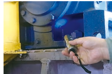
ブラックライトでの油漏れ確認
